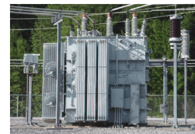
Високоволтов понижаващ трансформатор
